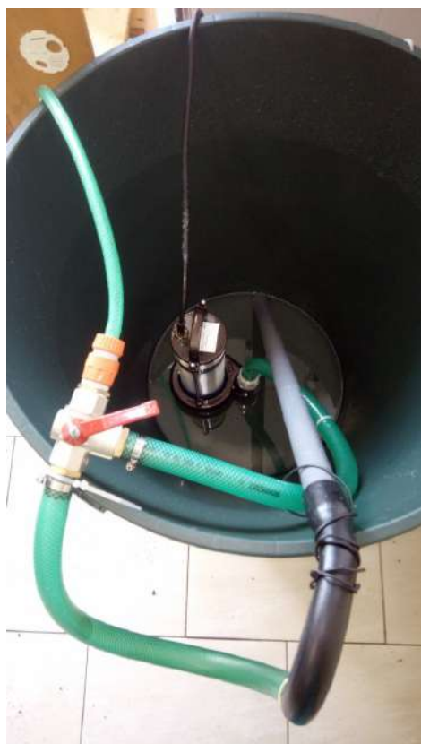
Obr. 1. Ponorné čerpadlo v kónickom plastovom sude. (foto: M.Staroň)
